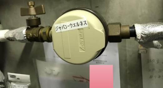
管理棟コンビニ水道子メーター①
