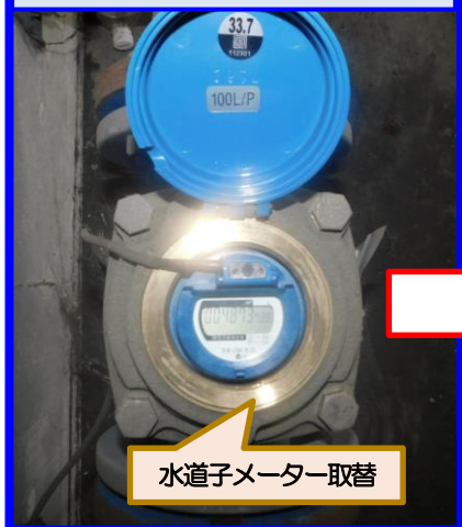
C棟テナント 水道子メーター
