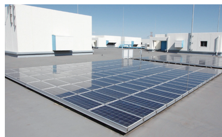
太陽光発電システム
