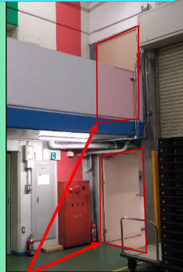
防火シャッター脇防火戸
