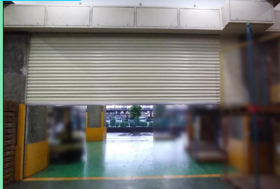
防火シャッター
