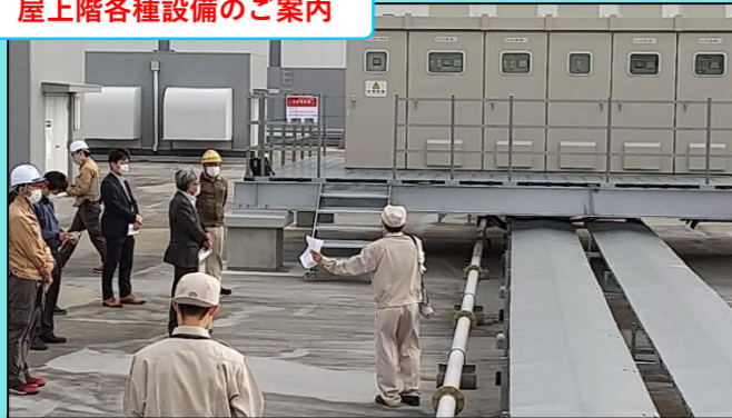
屋上階各種設備のご案内
