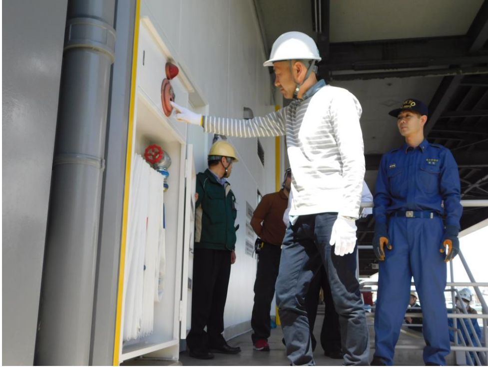
屋外消火栓起動ボタン押し
