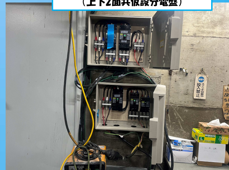
ELV機械室仮設分電盤設置状況 (上下2面共仮設分電盤)
