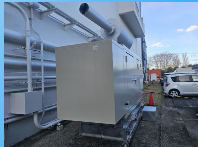
非常用発電機更新状況
