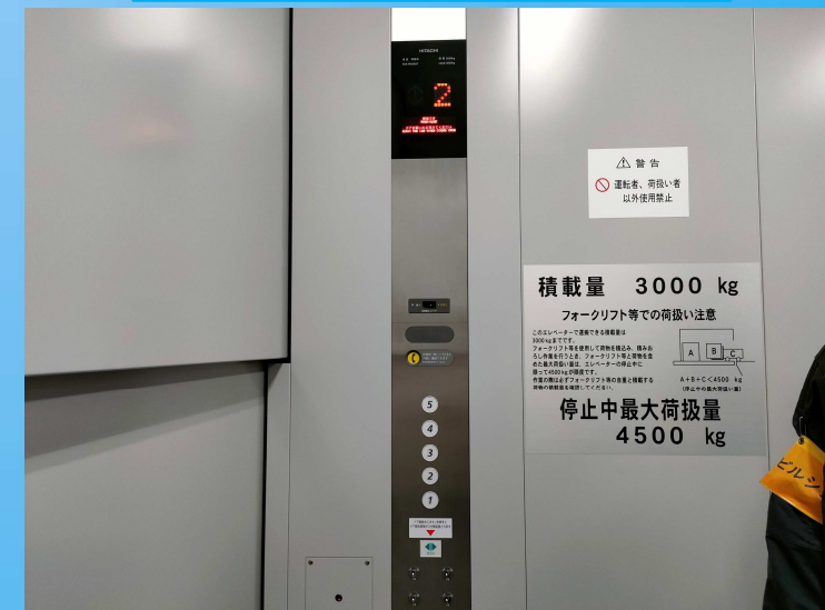
ELVかご内操作パネル
