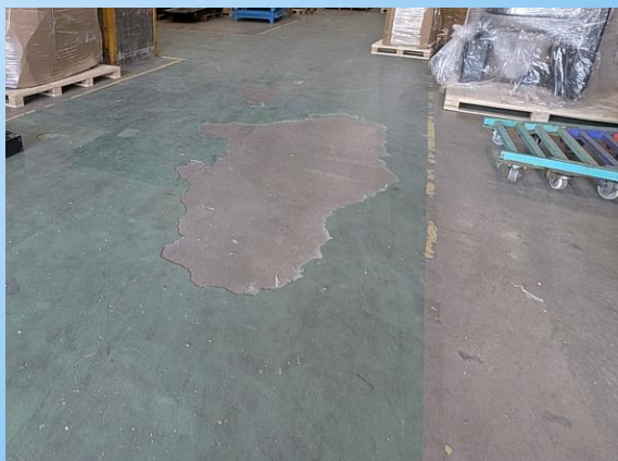
庫内床補修箇所現況（代表）
