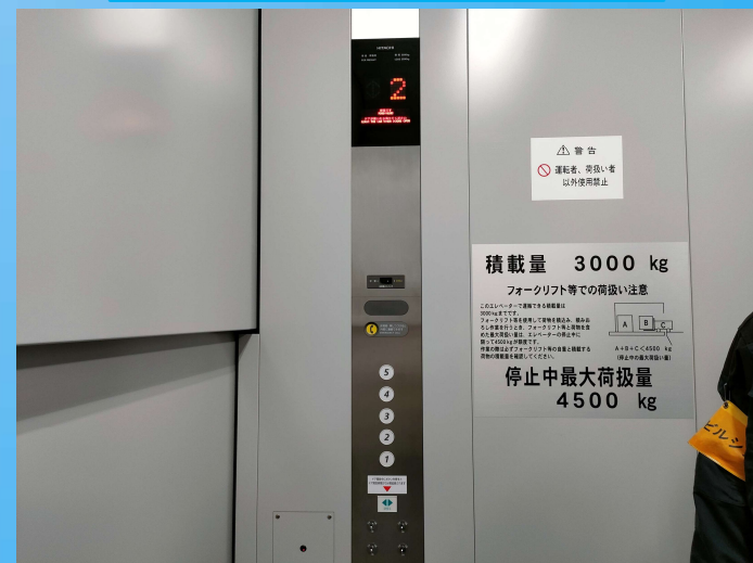
ELV内操作パネル
