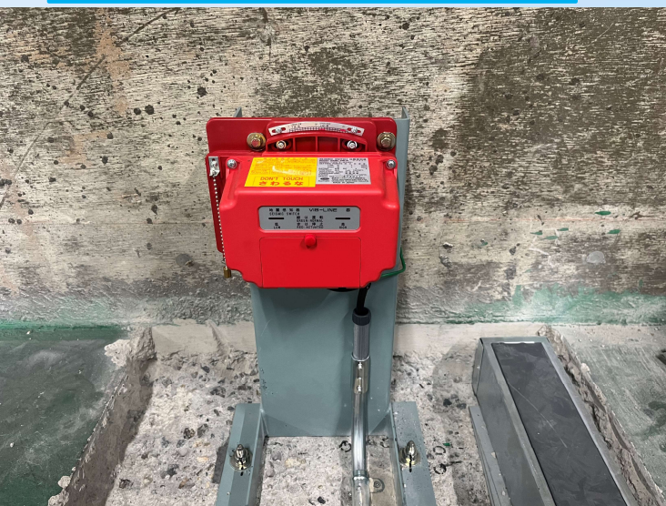
ELV機械室床上地震管制装置
