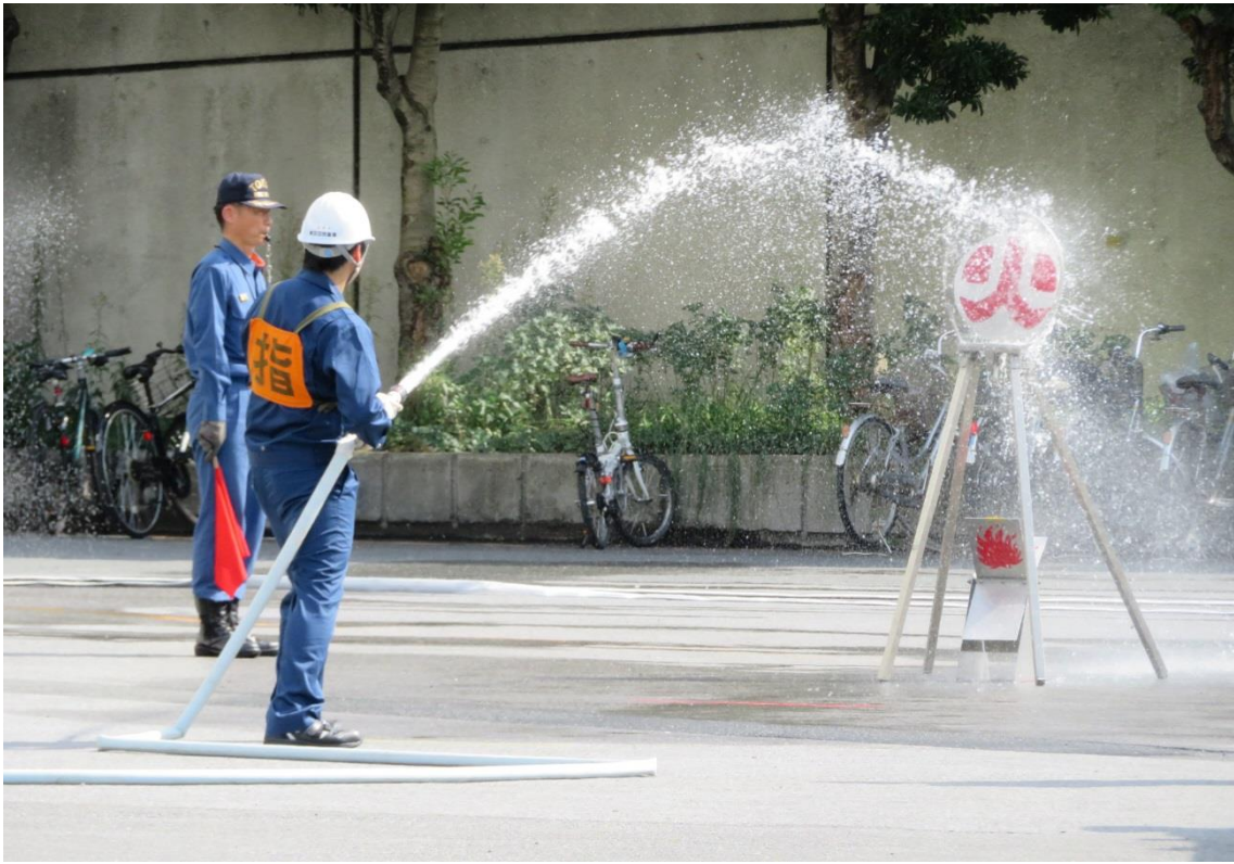
屋内消火栓 放水
