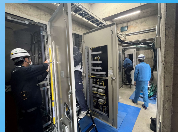
電気室 新設キュービクル設置状況
