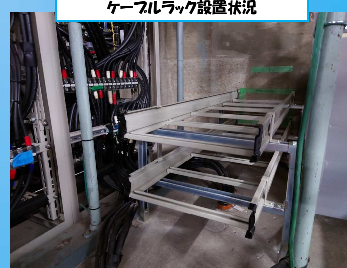
北棟屋上電気室内 ケーブルラック設置状況
