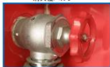
消火栓バルブ
