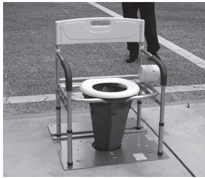
貯留槽に接続した仮設トイレ
