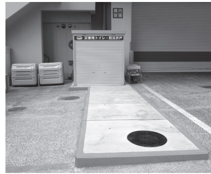
地下にトイレ用貯留槽が埋設
