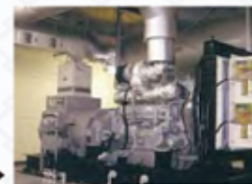
非常用発電機▶
