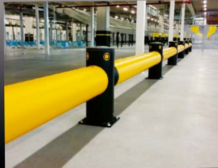
iFlexシングル車両バリアが、新築の梱包施設で車両の隔離に用いられています。
