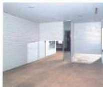
防火シャッター
